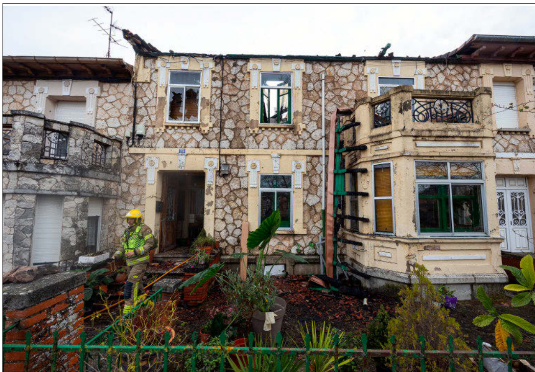
Imagen de la vivienda en la que se declaró el incendio. TOMÁS ALONSO
