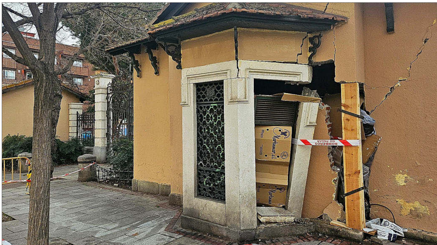
Uno de los dos casetones que desde 2005 sostienen la Puerta Bonita, en Carabanchel, ayer, tras sufrir el viernes el impacto de un vehículo de la Policía. E. M.
